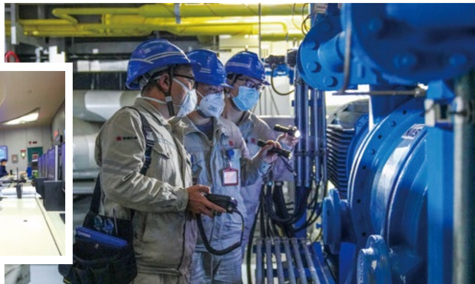
广东大唐国际肇庆热电公司全力保障园区电力供应
