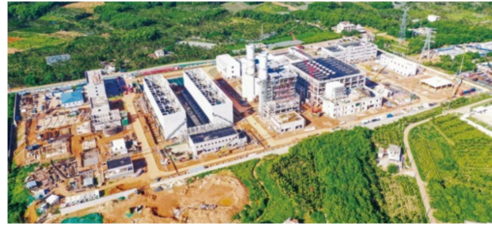
▲ 大力推进大唐海南能源开发公司万宁天然气发电项目的建设
