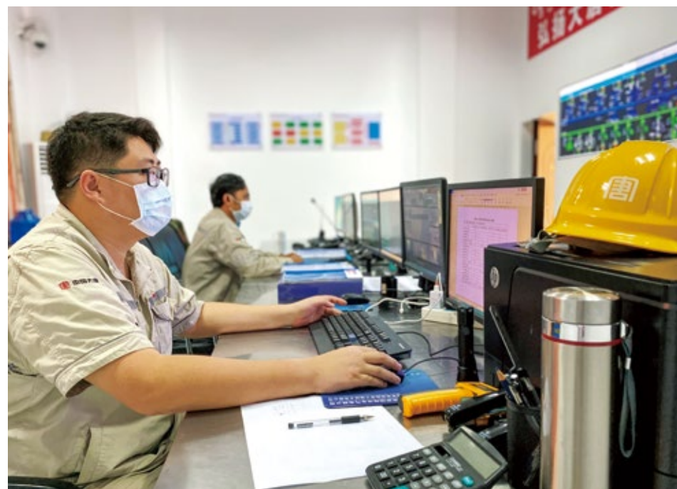
◀ 柬埔寨电网公司菩萨变电站员工在认真监屏
