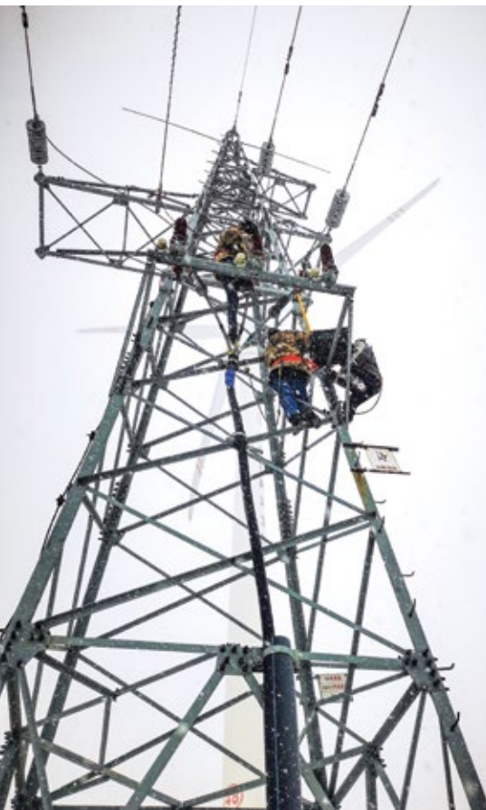
▲ 大唐承德新能源事业部的抢修人员顶风冒雪登塔排查故障
