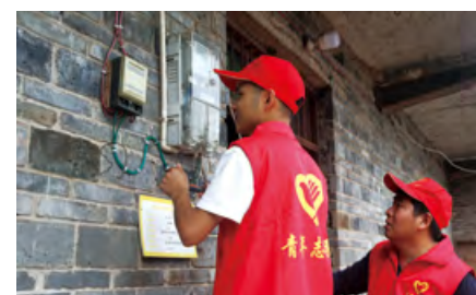
大唐重庆分公司驻村干部为留守老人家里更换老旧线路
